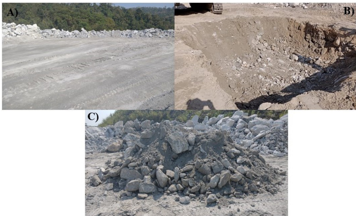
Figura 2. Ensaio realizado em campo. (A) primitivo da área com material compactado. (B) material escavado em forma de caixote. (C) material basculado em pilha.
